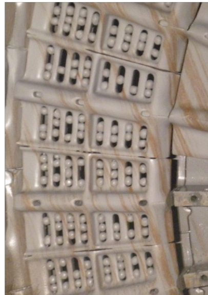
Cegado de parrilla Bolas incrustadas en los slots de parrillas
